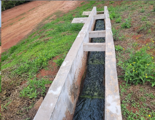
Foto 32 – Escada hidráulica da saída da ETE. Nota-se a coloração esverdeada no efluente tratado.
