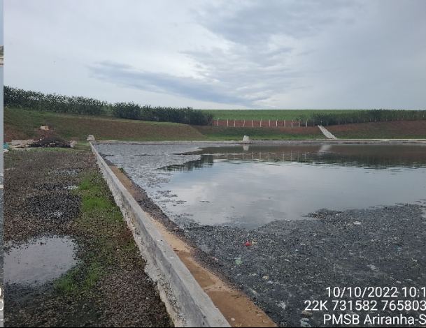
Foto 26 – ETE - Acúmulo de espuma com presença de resíduos sólidos grosseiros na primeira lagoa.
