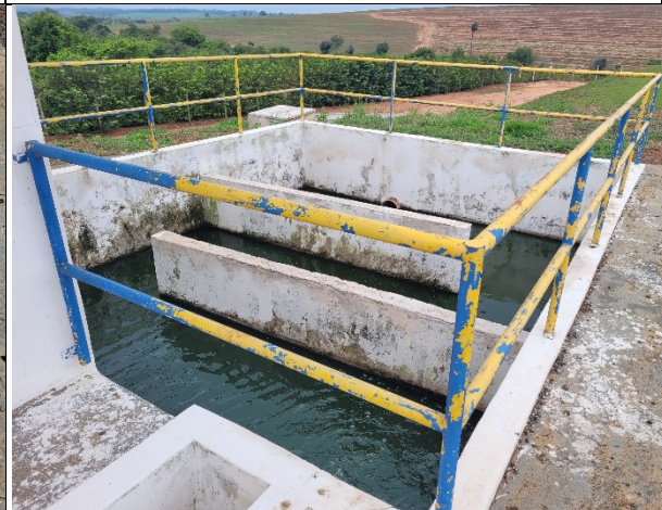
Foto 30 – Chicanas para tratamento terciário (não é realizada a adição de químicos).
