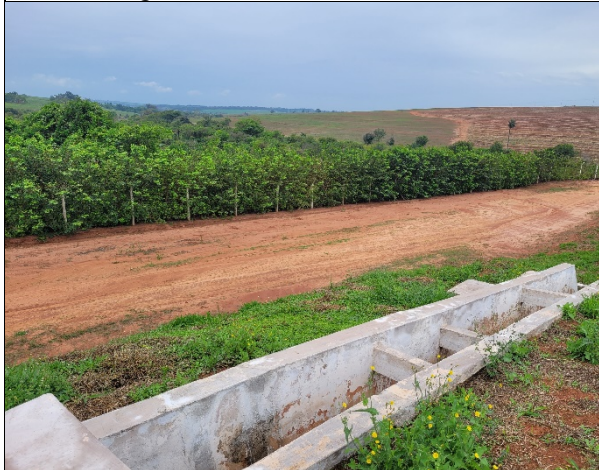
Foto 31 – Escada hidráulica da saída da ETE, para oxigenação do efluente tratado antes do lançamento.
