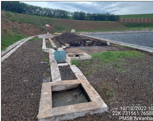
Foto 21 – Entrada do efluente da ETE.
