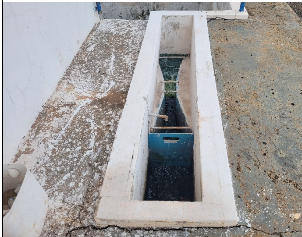
Foto 29 – Calha Parshal localizada na saída da terceira lagoa.
