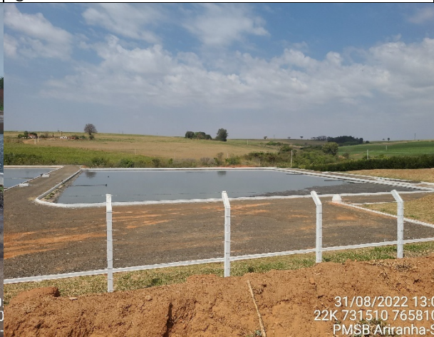
Foto 24 – ETE - Primeira lagoa – Lagoa Anaeróbia
