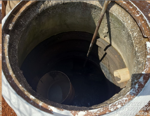
Foto 16 – Grade de remoção de resíduos sólidos – vista do poço de visita da estação elevatória.
