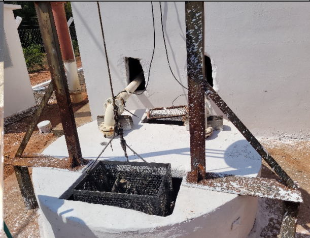
Foto 18 – Cesta para remoção de resíduos sólidos antes das bombas da estação elevatória de esgoto – remoção manual do material coletado.
