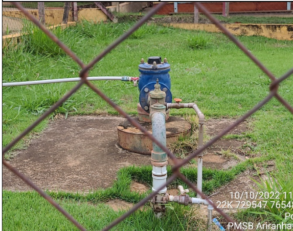
Foto 11 – Detalhe do macromedidor do Poço 05 – Setor 2.
