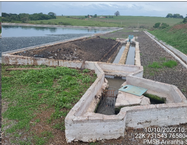
Foto 22 – Entrada do efluente da ETE – gradeamento.
