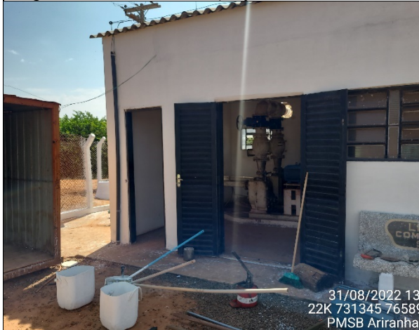
Foto 19 – Estação elevatória de esgoto.
