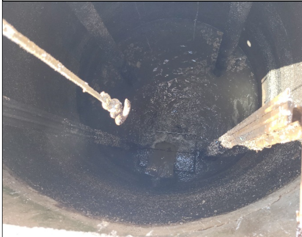
Foto 17 – Cesta para remoção de resíduos sólidos antes das bombas da estação elevatória de esgoto – vista interna do poço
