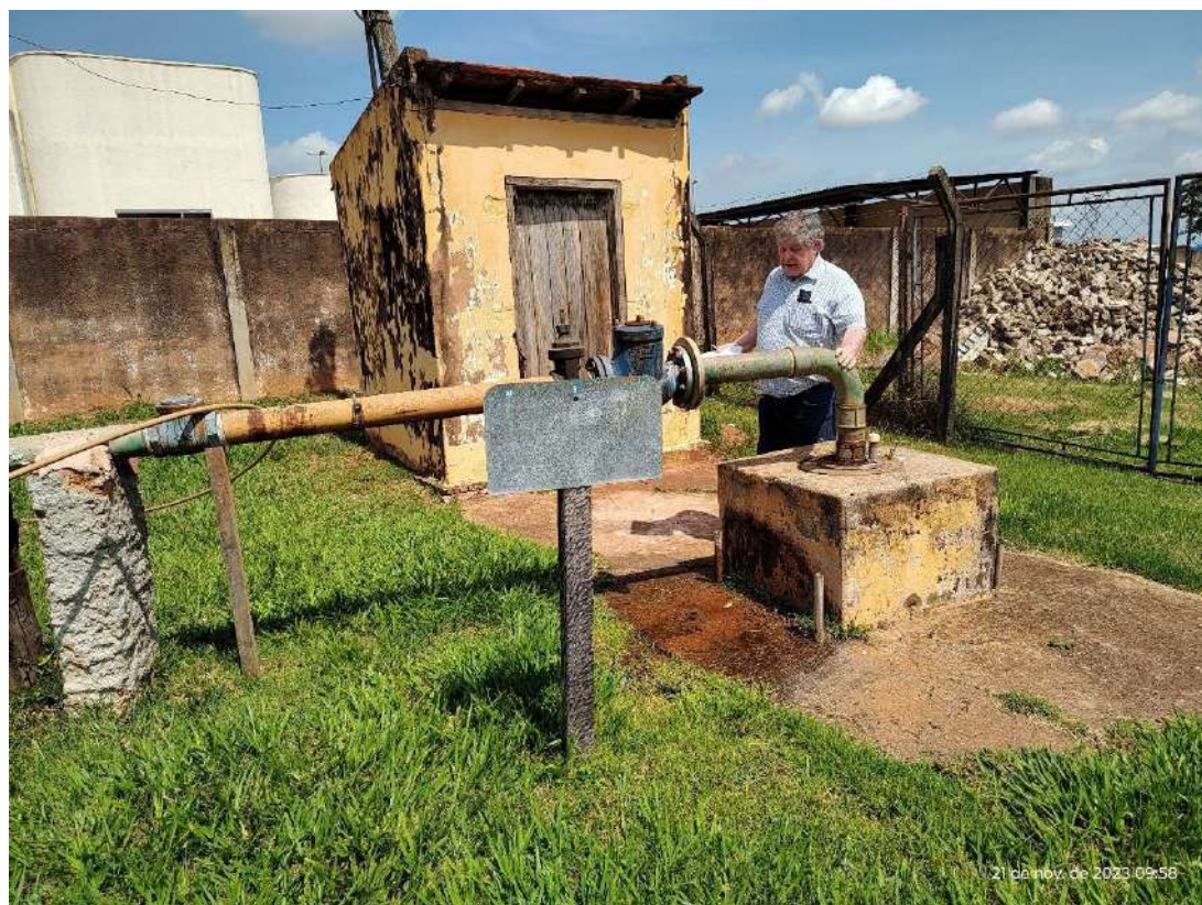
Foto 4 Vista do barrilete do Poço 10
