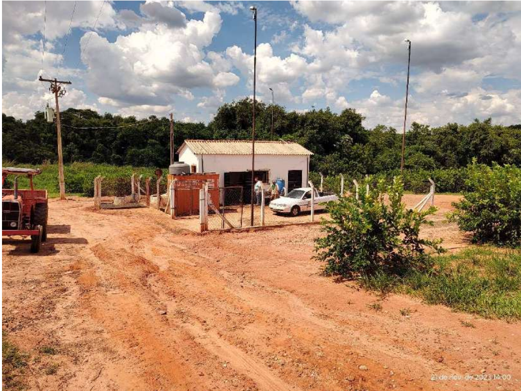
Foto 31 Vista geral da estação elevatória
