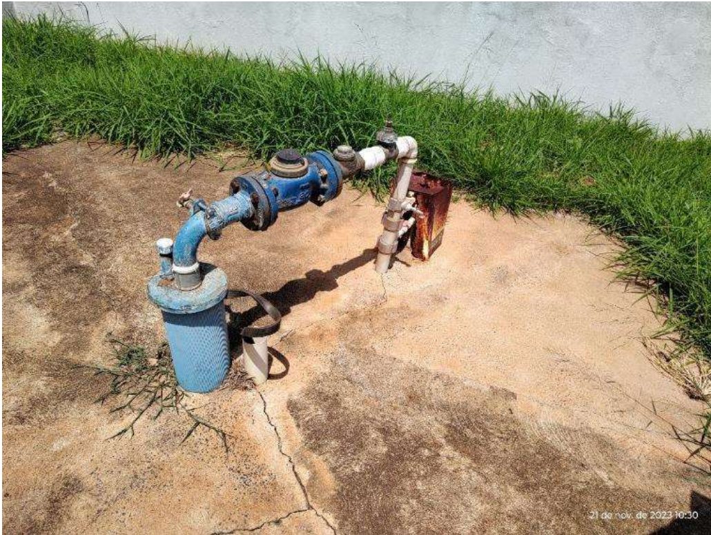
Foto 16 Sistema 3. Vista do barrilete do poço 6.
