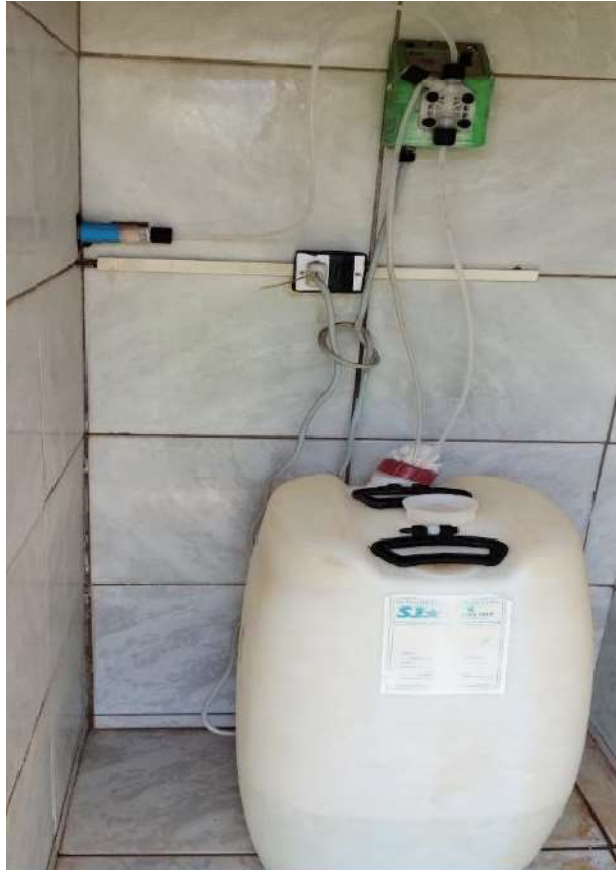
Foto 20 Sistema 4. Vista da bombona de armazenamento e bomba dosadora de solução de ácido fluossilícico
