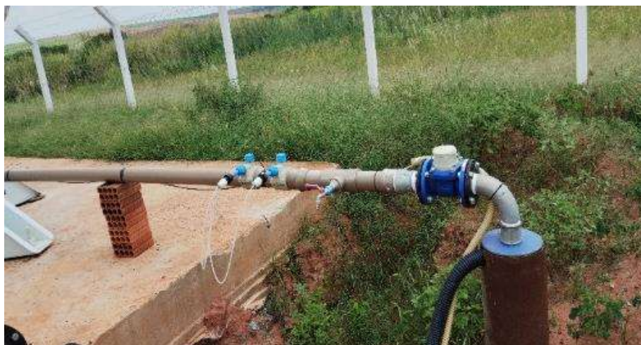
Foto 29 Vista do barrilete do poço 16
