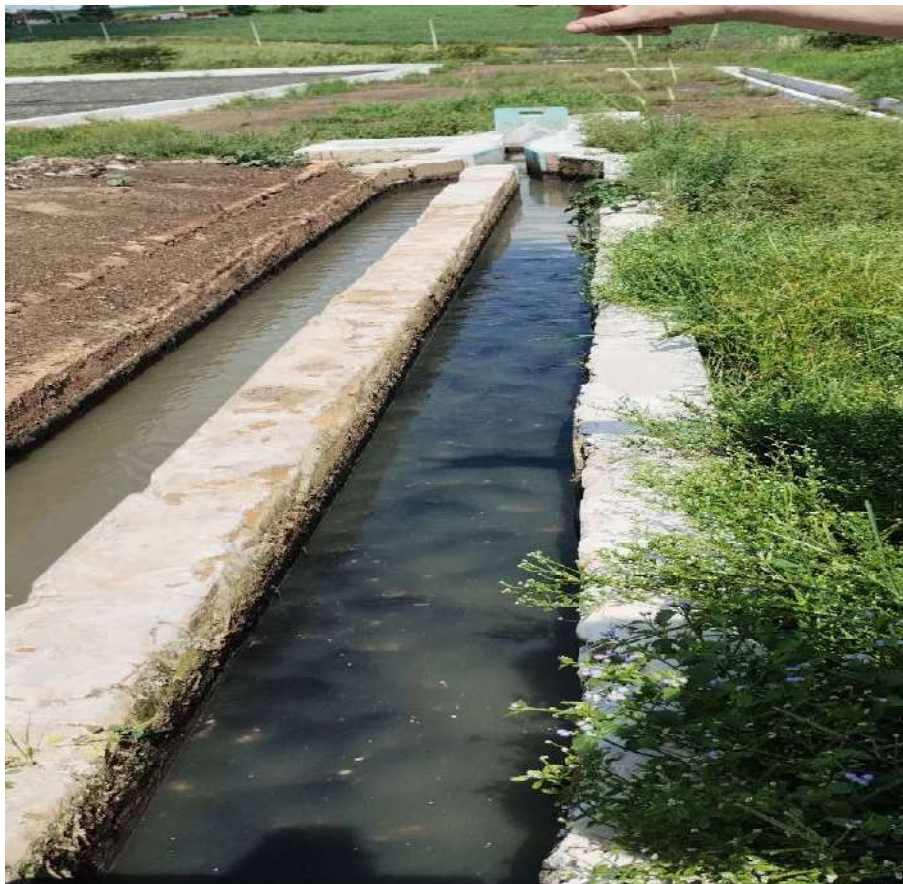
Foto 37 Vista dos canais de desarenação e ao fundo caixa de chegada dos esgotos e gradeamento
