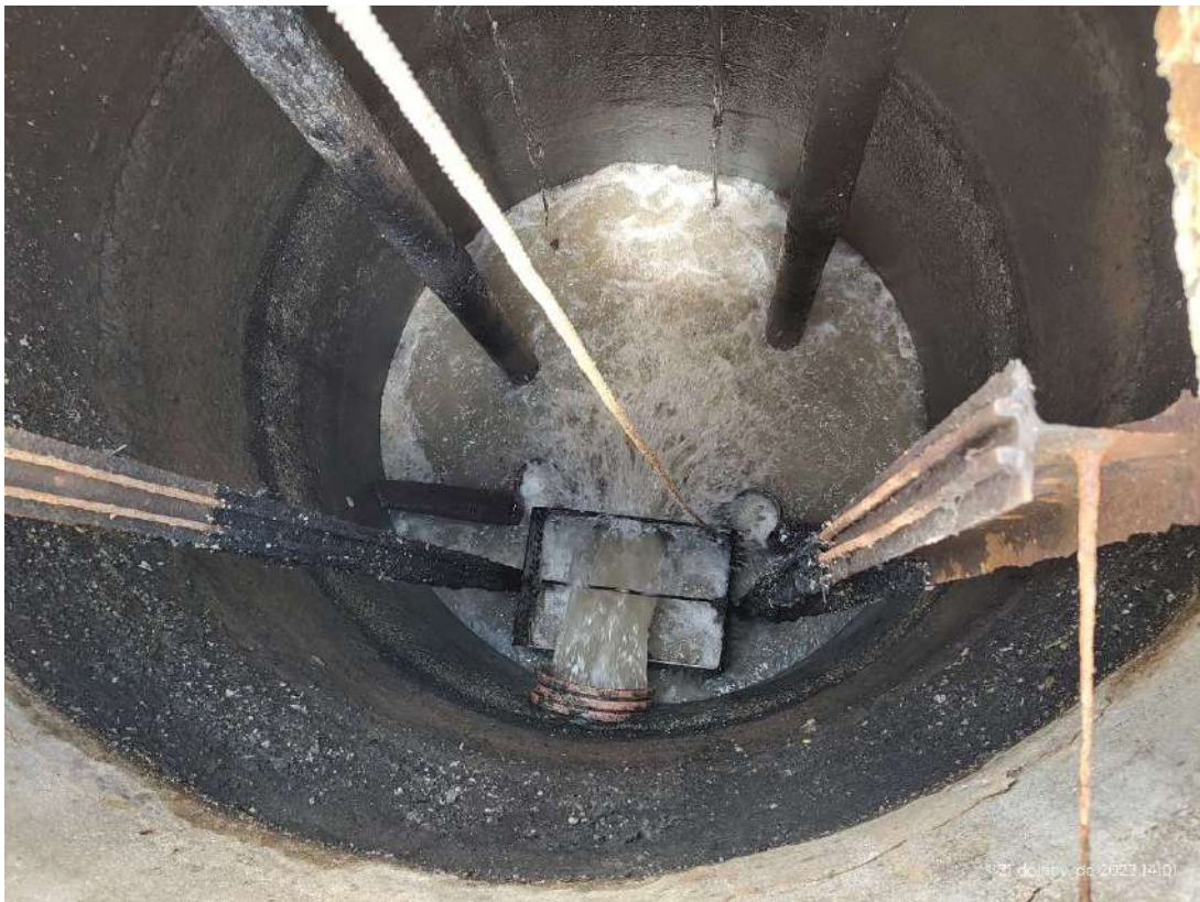
Foto 32 Vista interna do poço de sucção e cesto de retenção de sólidos
