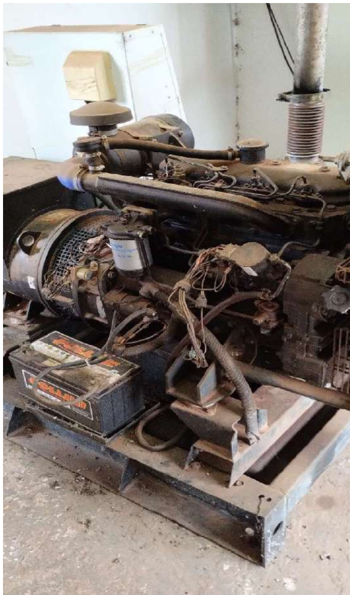
Foto 35 Vista do gerador elétrico
