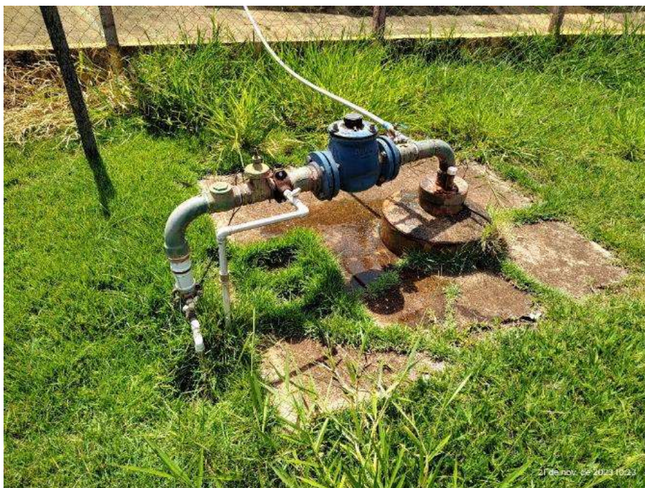
Foto 19 Sistema 4. Vista do barrilete do poço 13
