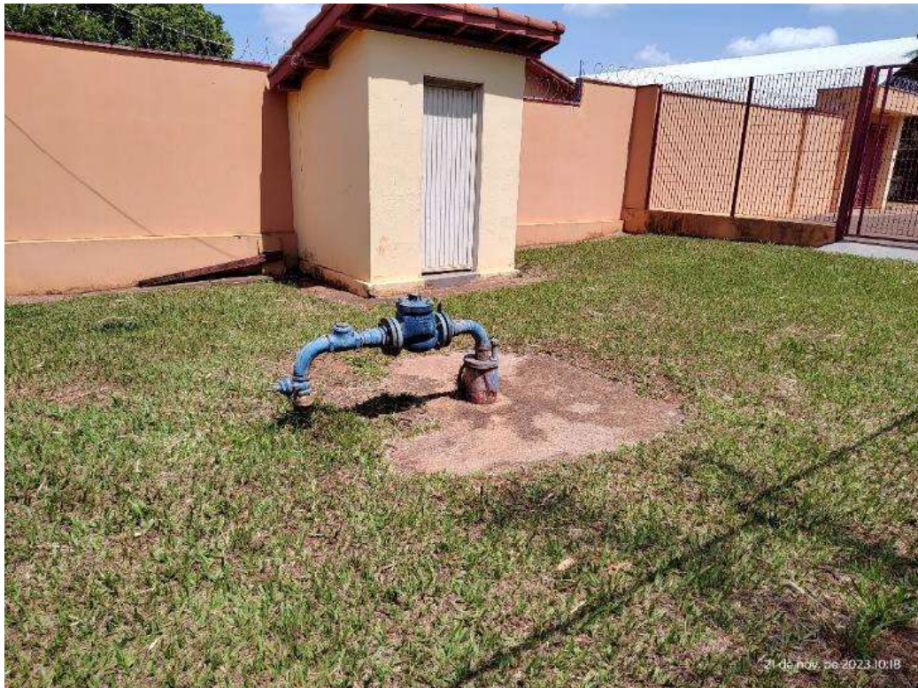
Foto 12 Vista geral e barrilete do poço 5
