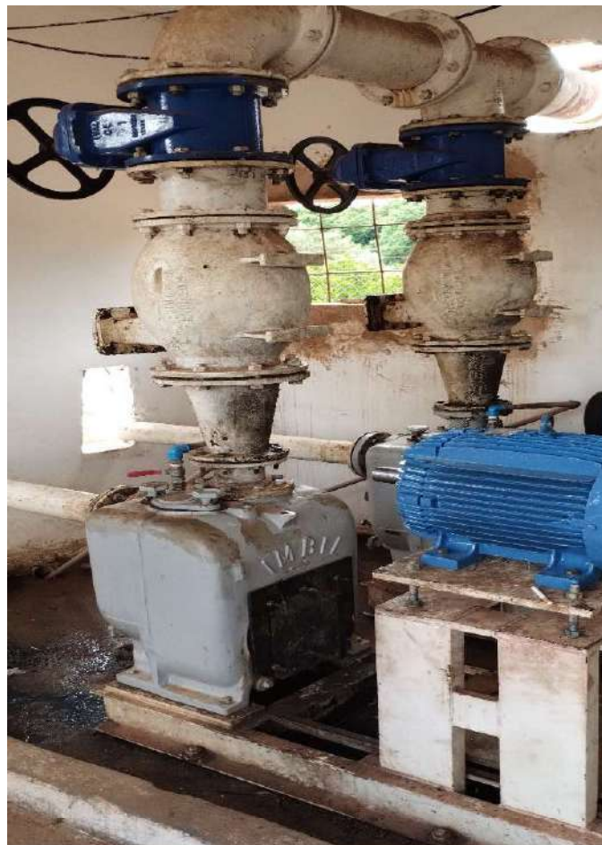
Foto 34 Vista dos conjuntos motobomba
