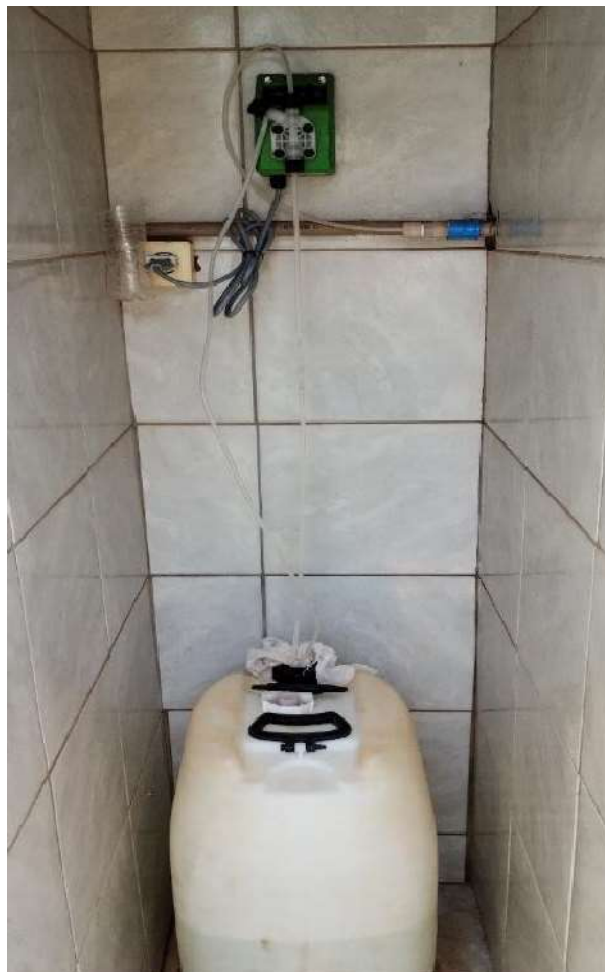
Foto 23 Sistema 5. Vista da bombona de armazenamento e bomba dosadora de solução de hipoclorito de sódio
