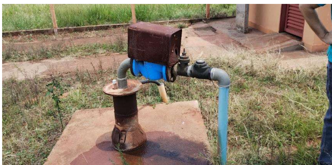
Foto 25 Vista do barrilete do poço 14
