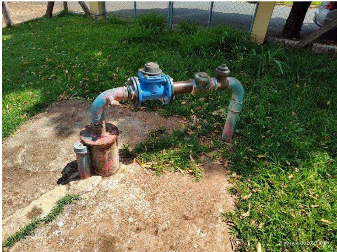
Foto 11 Vista do barrilete do poço 11
