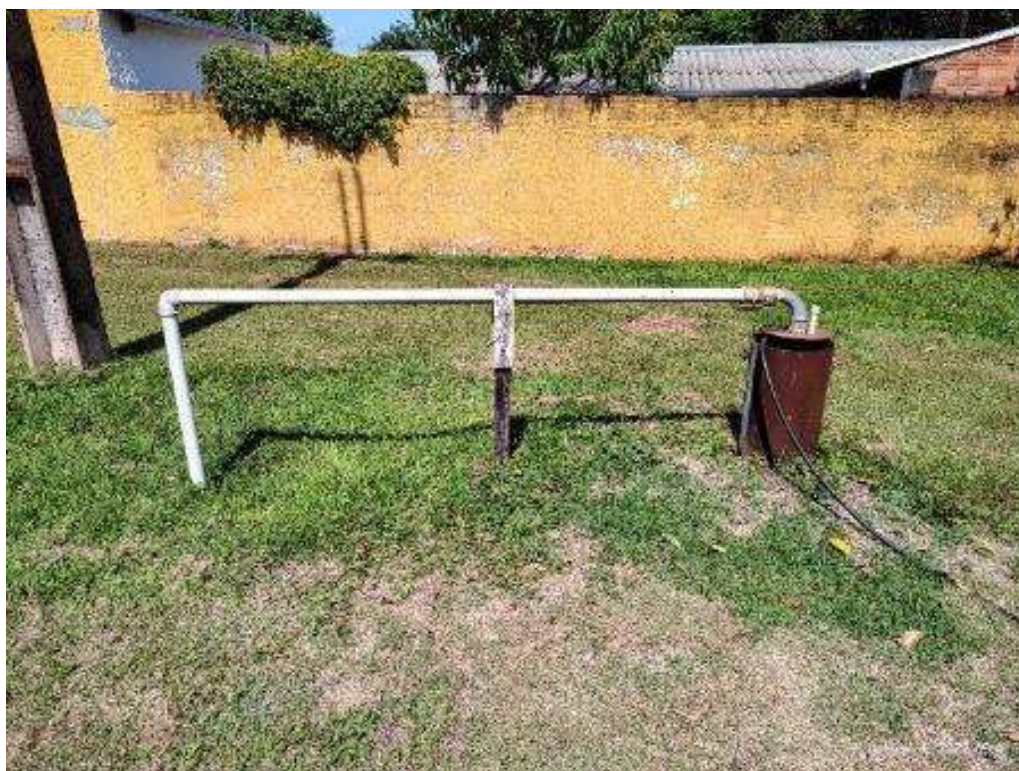
Foto 2 Vista do barrilete do Poço 7
