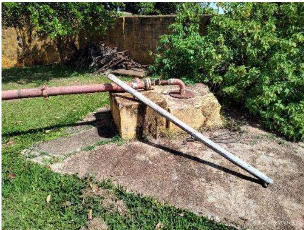
Foto 1 Vista do barrilete do Poço 8
