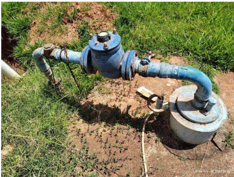
Foto 21 Sistema 5. Vista do barrilete do poço 12
