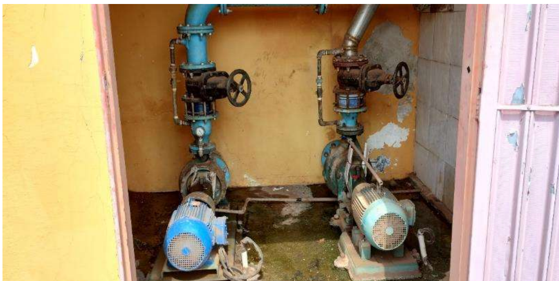
Foto 7 Vista da elevatória de alimentação do reservatório elevado
