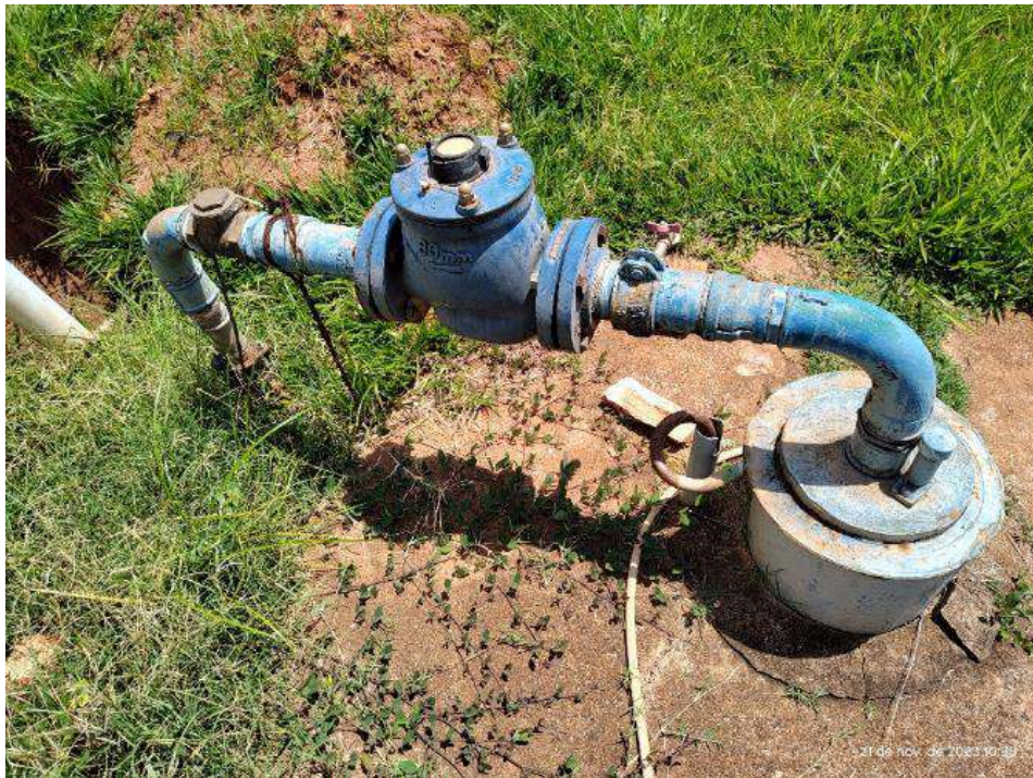
Foto 21 Sistema 5. Vista do barrilete do poço 12
