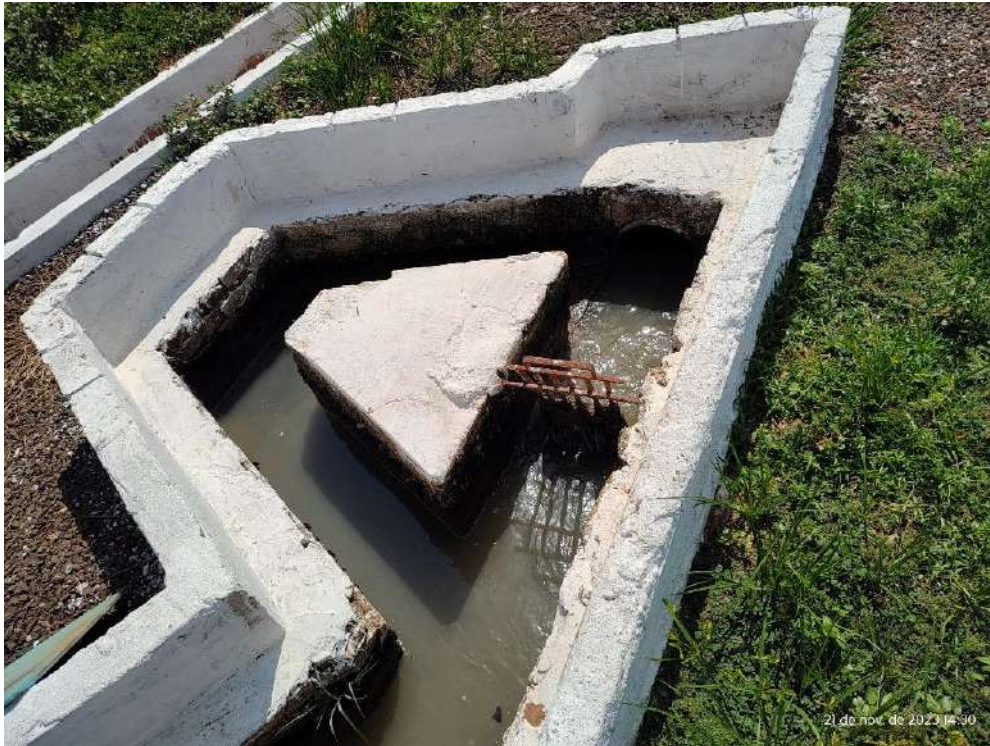
Foto 36 Vista da caixa de chegada e grade média de limpeza manual
