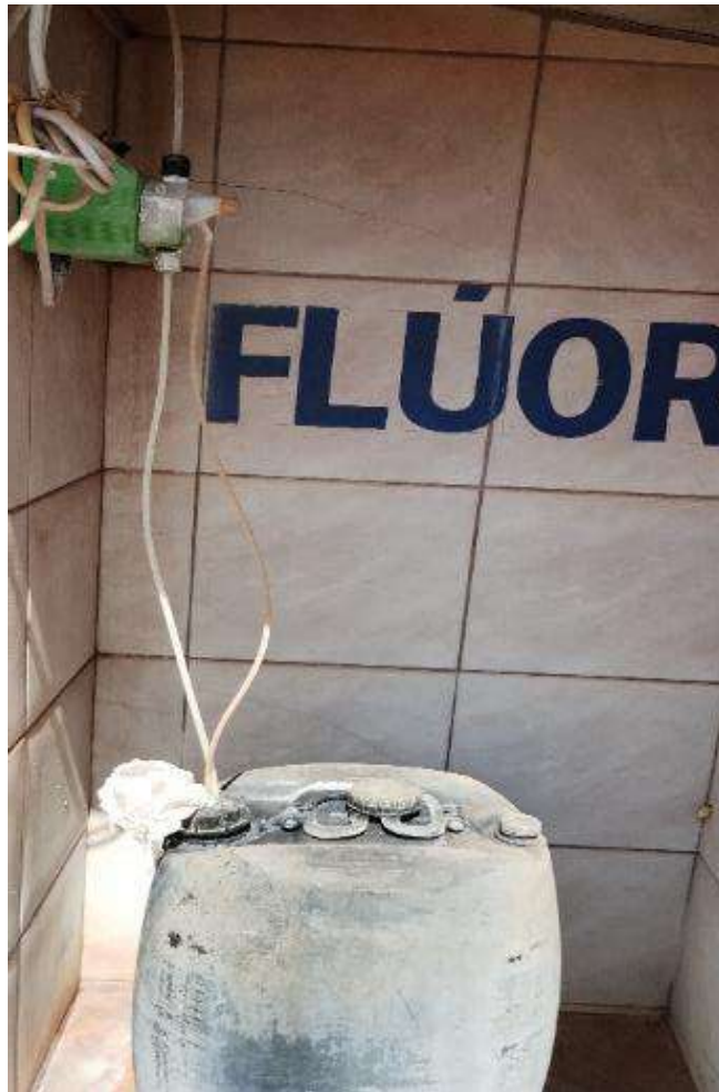
Foto 9 Vista das instalações de armazenamento e dosagem de ácido fluossilícico
