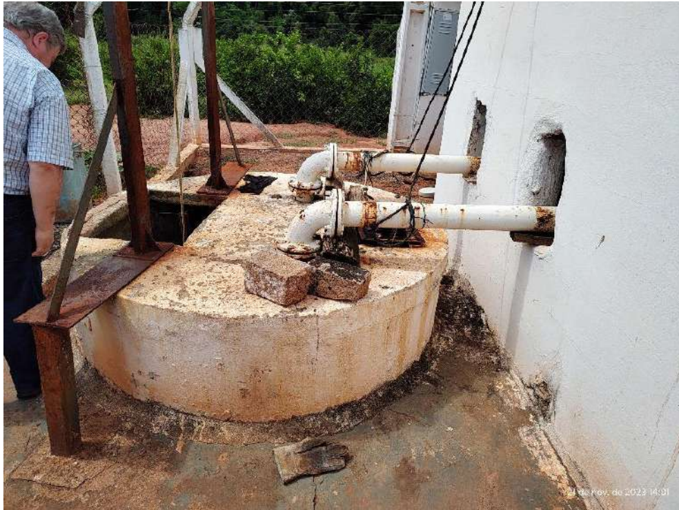
Foto 33 Vista externa do poço e barrilete de sucção dos conjuntos motobomba
