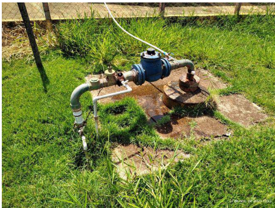
Foto 19 Sistema 4. Vista do barrilete do poço 13
