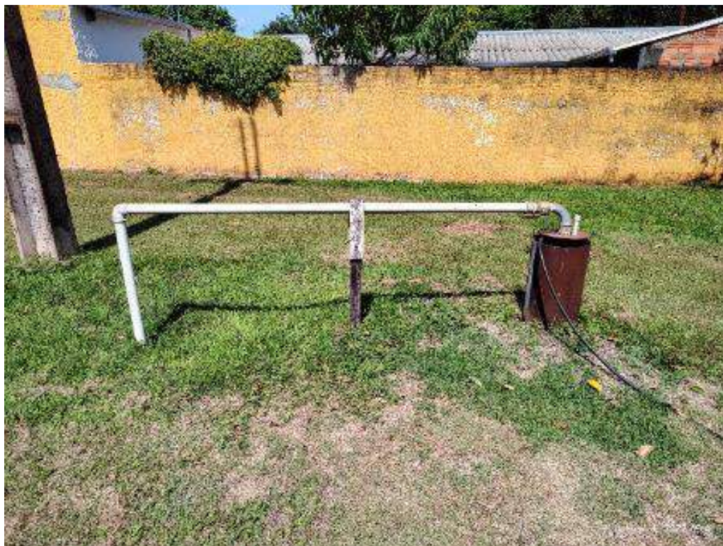
Foto 2 Vista do barrilete do Poço 7
