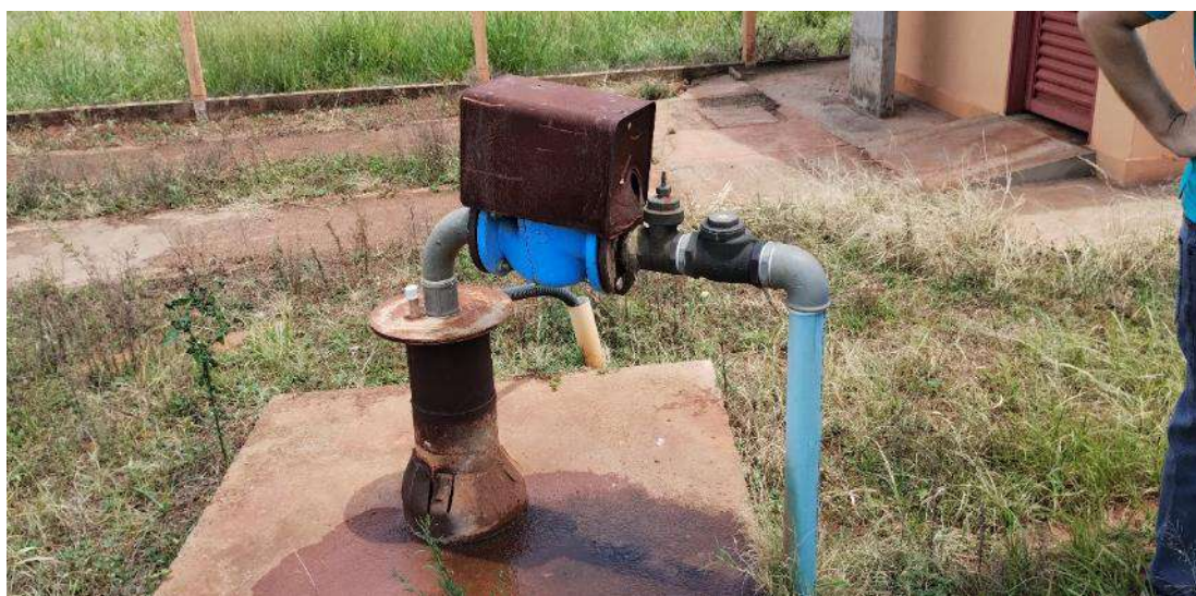
Foto 25 Vista do barrilete do poço 14
