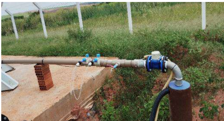
Foto 29 Vista do barrilete do poço 16
