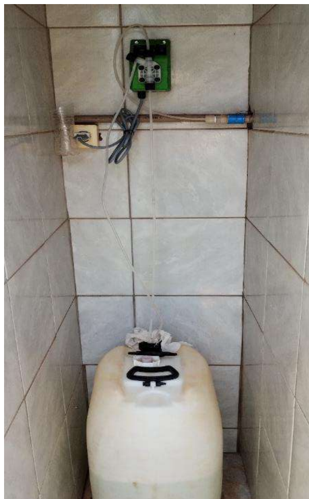
Foto 23 Sistema 5. Vista da bombona de armazenamento e bomba dosadora de solução de hipoclorito de sódio
