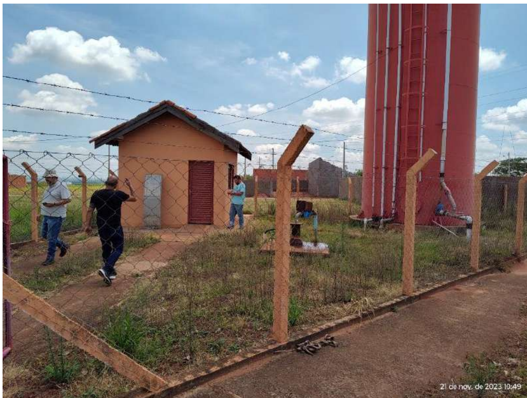
Foto 24 Vista geral do Sistema 6 de produção e reservação
