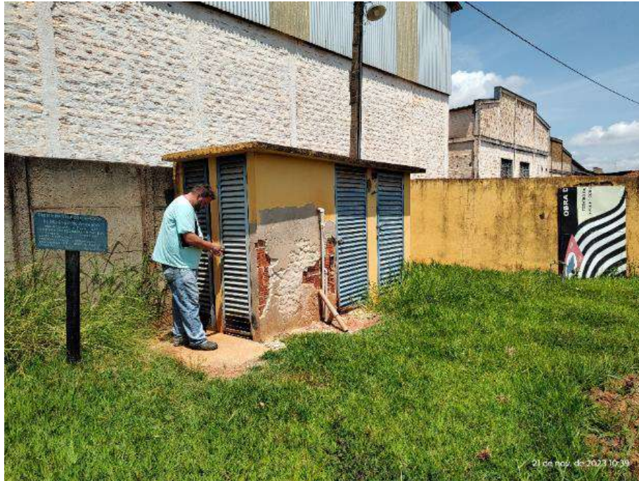
Foto 22 Sistema 5. Vista do nicho de abrigo do quadro elétrico e sistema de tratamento simplificado
