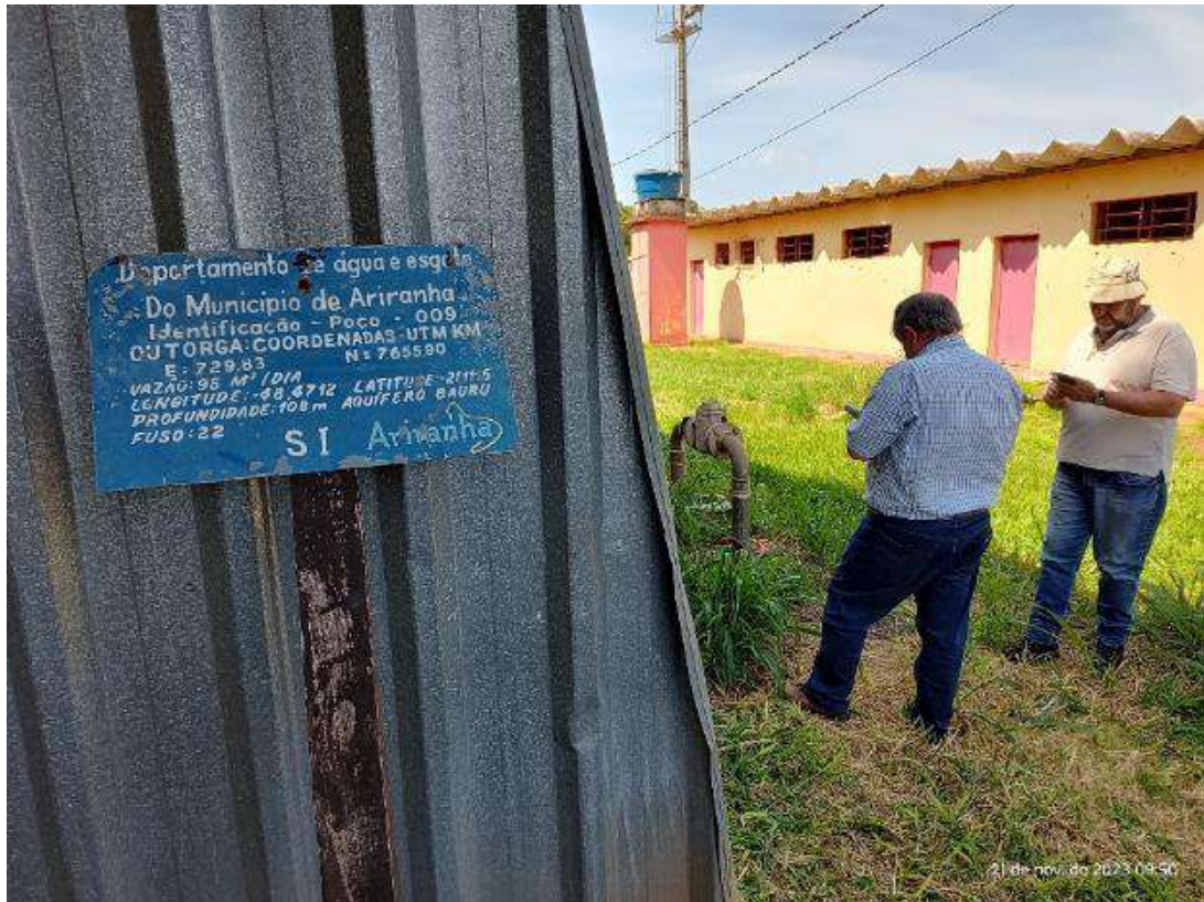
Foto 3 Vista do barrilete do Poço 9
