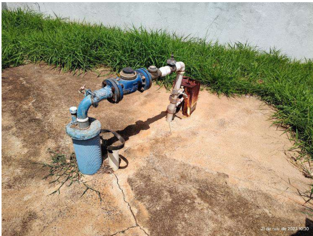
Foto 16 Sistema 3. Vista do barrilete do poço 6.
