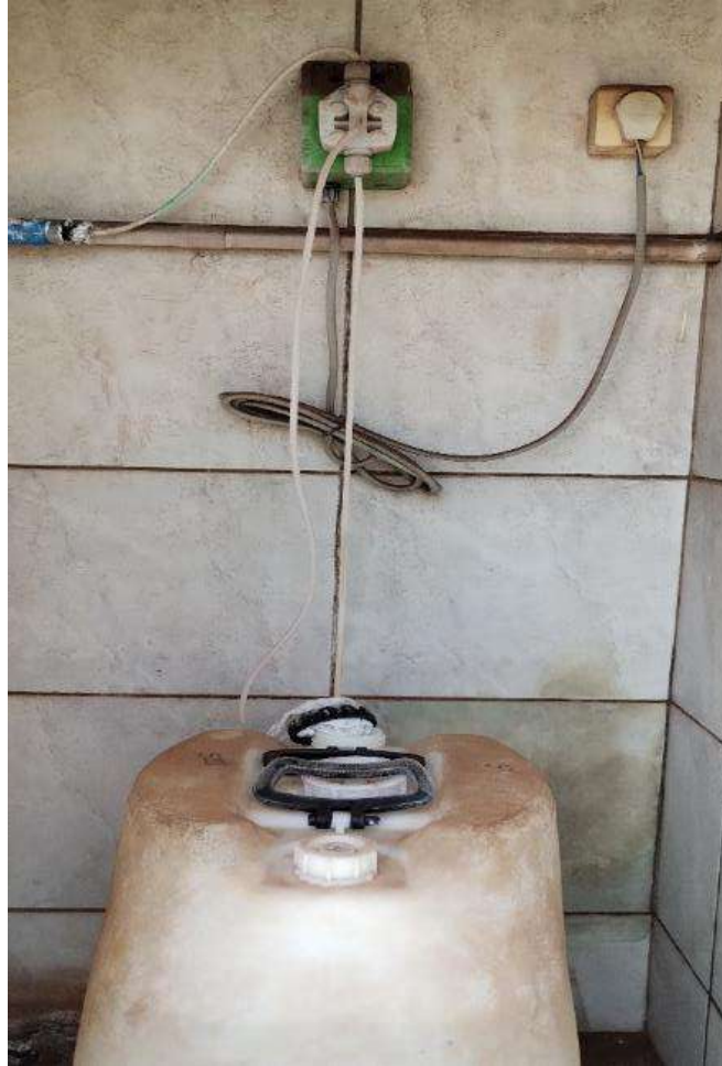
Foto 18 Sistema 3. Vista da bombona de armazenamento e bomba dosadora de solução de hipoclorito de sódio
