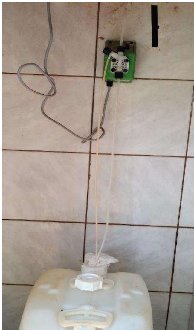
Foto 8 Vista das instalações de armazenamento e dosagem de hipoclorito de sódio
