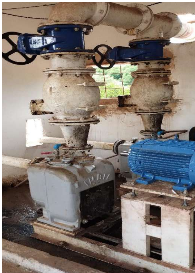
Foto 34 Vista dos conjuntos motobomba
