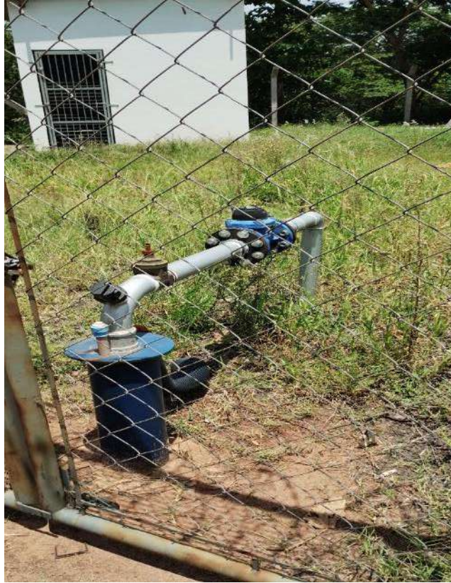
Foto 27 Vista do barrilete do poço 15. Ao fundo, nicho de abrigo do quadro elétrico e do sistema de tratamento simplificado
