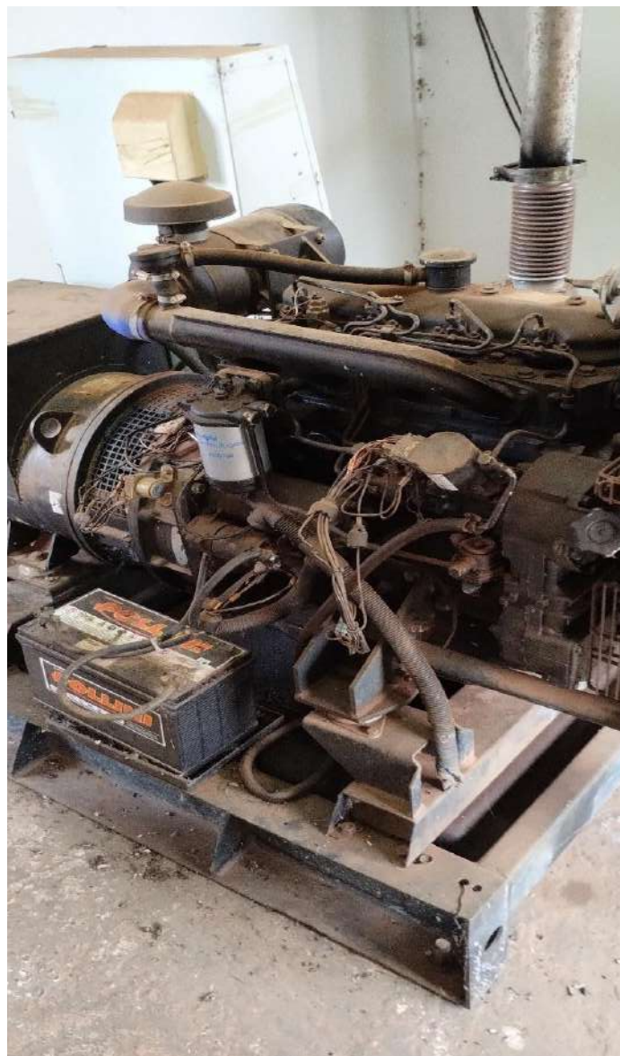
Foto 35 Vista do gerador elétrico
