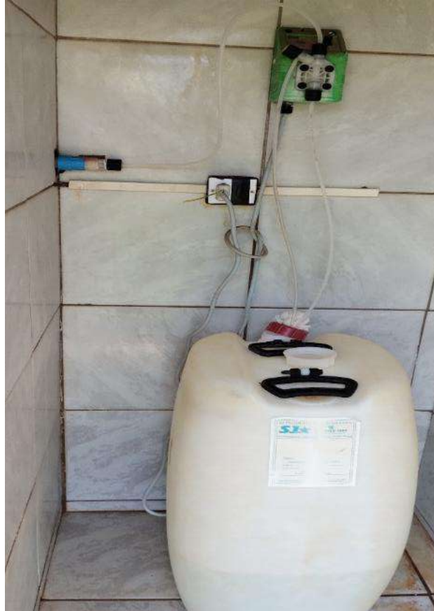
Foto 20 Sistema 4. Vista da bomba de armazenamento e bomba dosadora de solução de ácido fluossilícico
