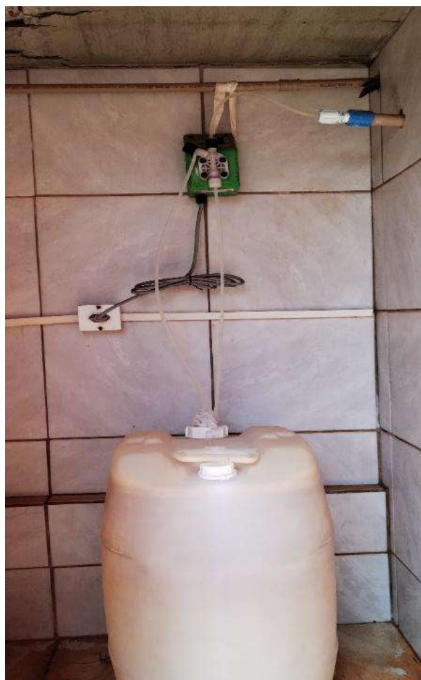
Foto 15 Vista das instalações de armazenamento e dosagem de hipoclorito de sódio
