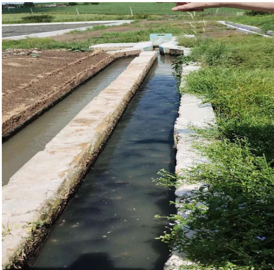
Foto 37 Vista dos canais de desarenação e ao fundo caixa de chegada dos esgotos e gradeamento
