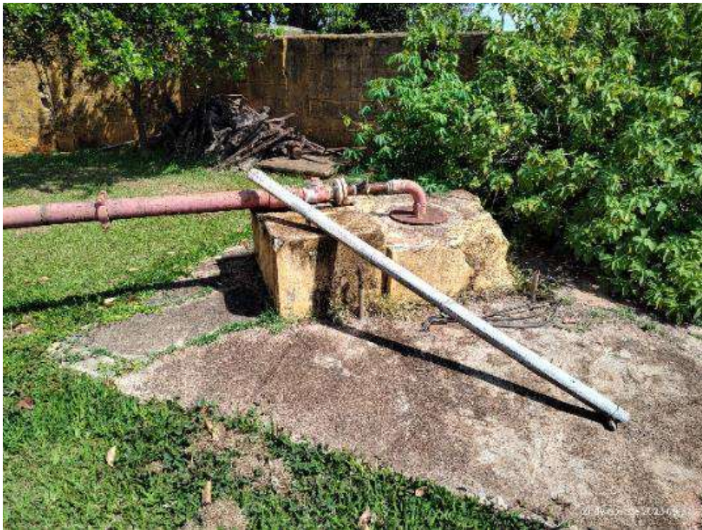
Foto 1 Vista do barrilete do Poço 8
