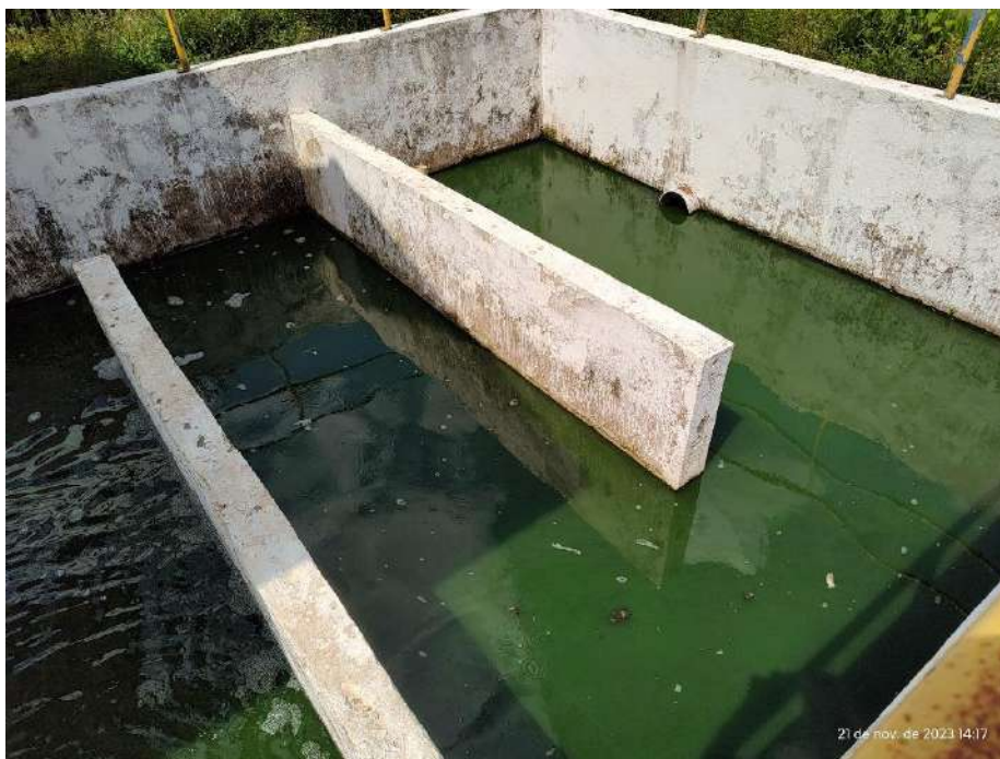
Foto 42 Vista parcial da câmara de contato
