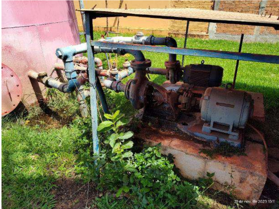
Foto 14 Vista da elevatória de alimentação do reservatório elevado
