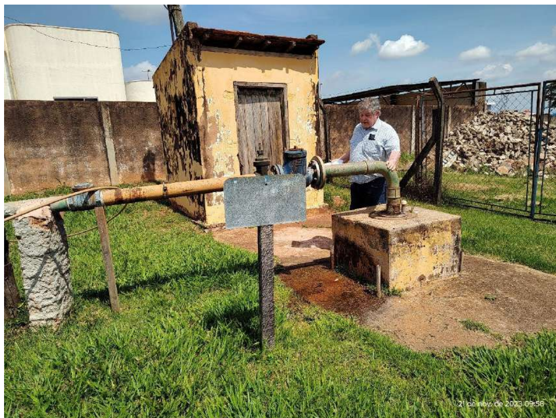
Foto 4 Vista do barrilete do Poço 10
