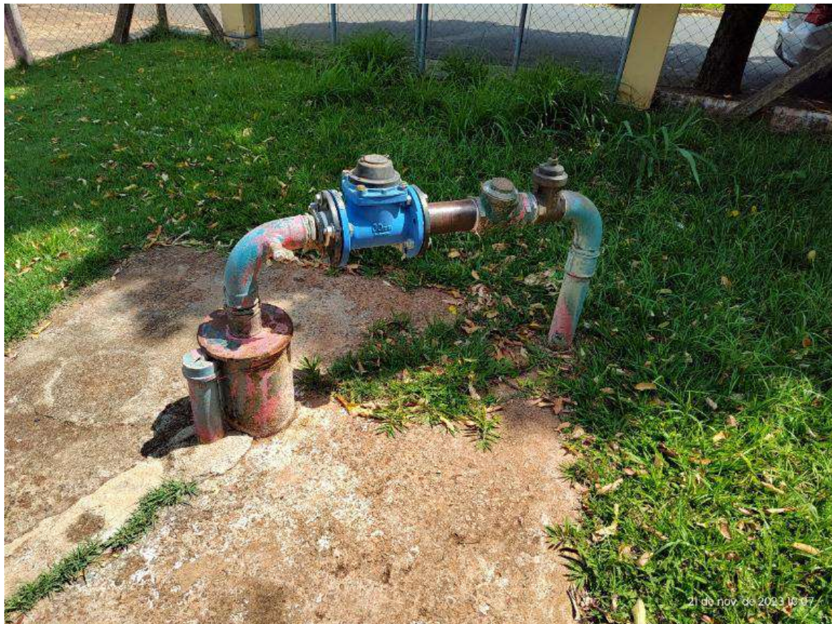
Foto 11 Vista do barrilete do poço 11
