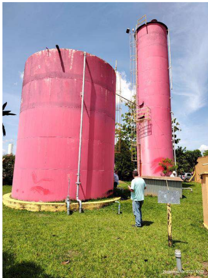
Foto 13 Vista dos reservatórios apoiado e elevado do CR2
